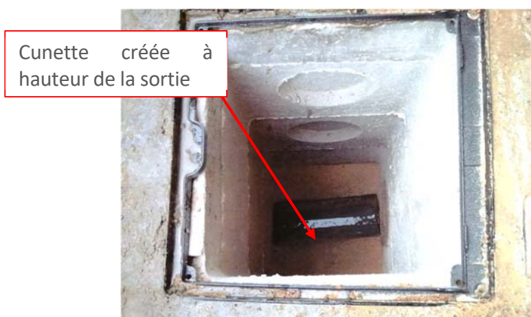
Figure 13: boîte de branchement en conformité, Versailles
